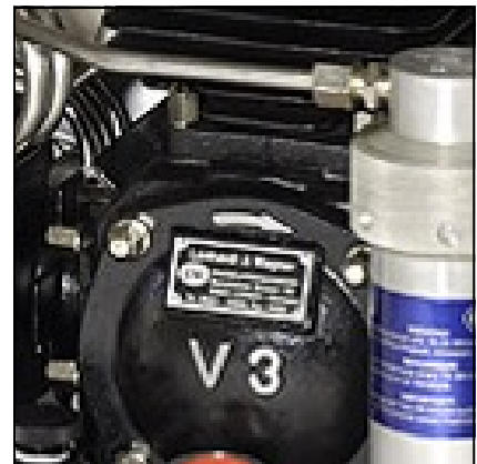
Drehrichtungspfeil auf dem Kompressorblock
